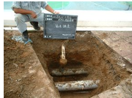
■プール ・循環配管
